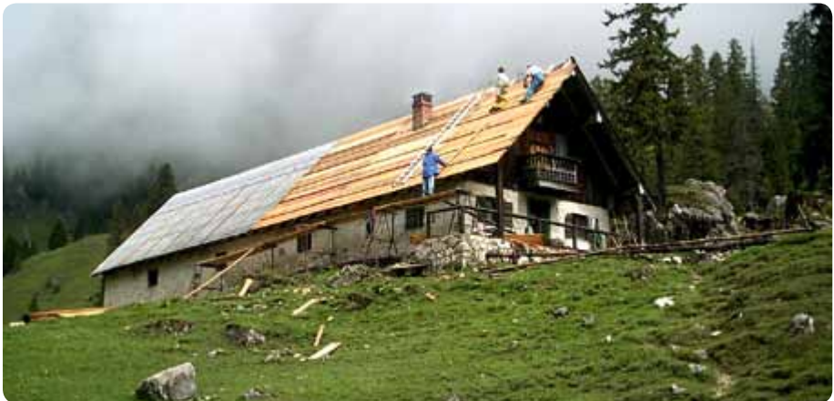
Foto 53: Das schadhafte Dach der Wendelsteinalm bei Bayrischzell (Lkr. Miesbach) konnte nur dank großzügiger Investitionsförderung erneuert werden. (Foto S. Krapfl)
